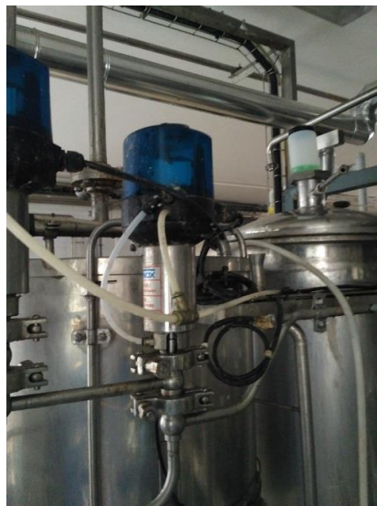
Ilustración 2.1.1-5 Válvula 5: purgador esterilización directo
