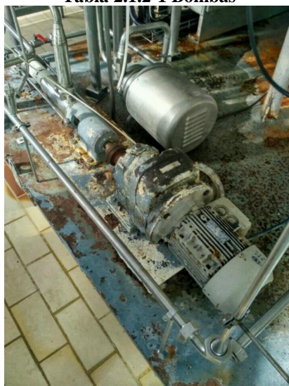
Ilustración 2.1.2-1 Bomba de alimentación N°1 y N°2
