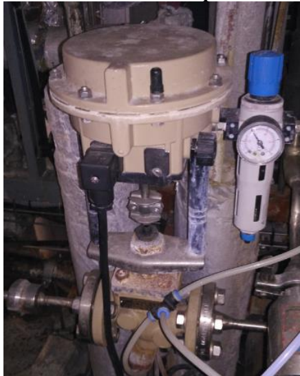
Ilustración 2.1.1-10 válvula 11: válvula de inyección de vapor
