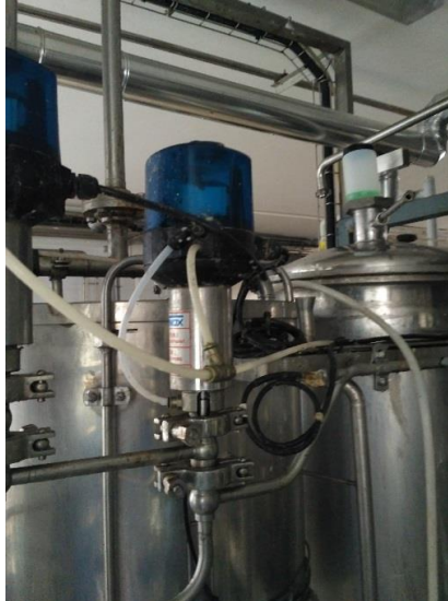
Ilustración 2.1.1-6 Válvula 6: producción/circuito de condensados
