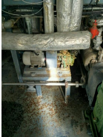
Ilustración 2.1.2-2 Bomba de agua caliente
