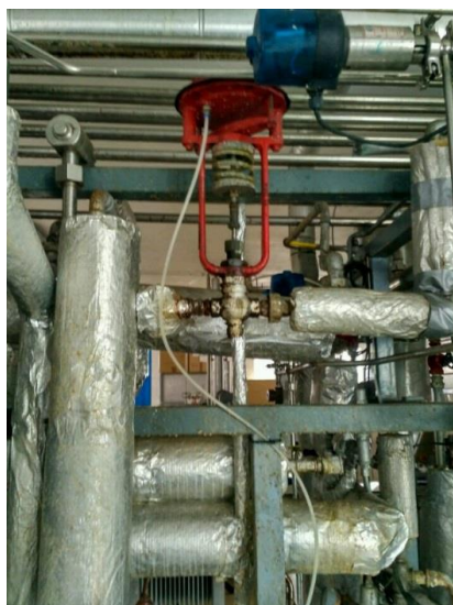
Ilustración 2.1.1-11 Válvula 12: válvula de inyección de vapor de agua caliente
