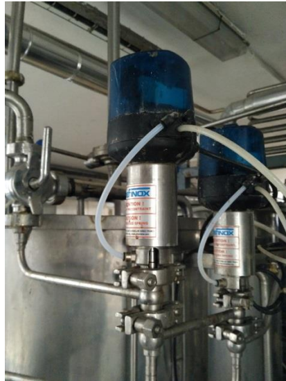
Ilustración 2.1.1-4 Válvula 4: salida producto/recirculación del producto.
