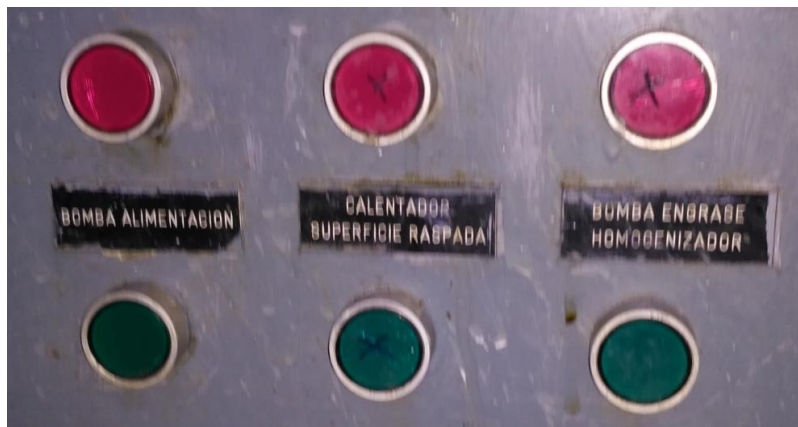
Ilustración 3.3-7 Pulsadores de bombas 2
