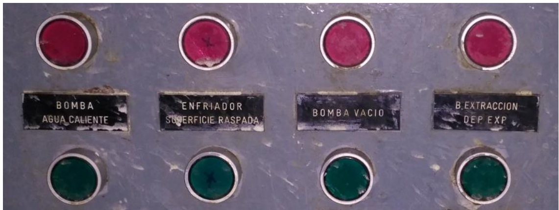
Ilustración 3.3-6 Pulsadores de bombas 1
