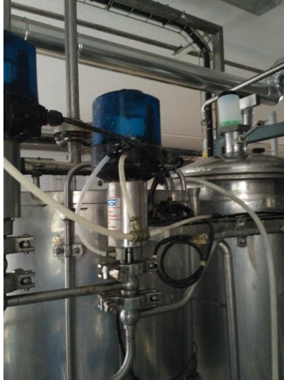
Ilustración 3.1.1-6 Válvula 6: producción/circuito de condensados
