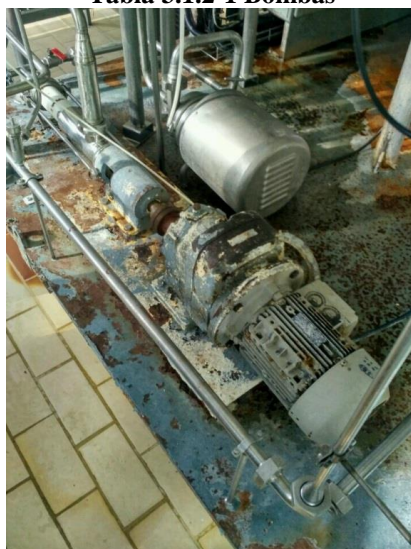
Ilustración 3.1.2-1 Bomba de alimentación N°1 y N°2
