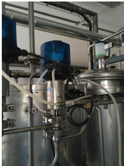
Ilustración 3.1.1-5 Válvula 5: purgador esterilización directo
