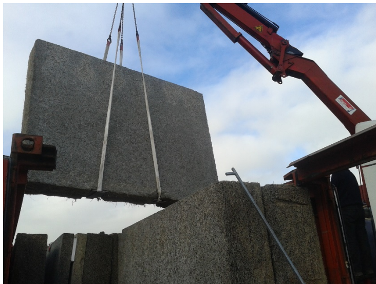
Figura 7: desperfectos originados por el descuelgue de una de las barras del contenedor y por las bridas de agarre para introducción/extracción
