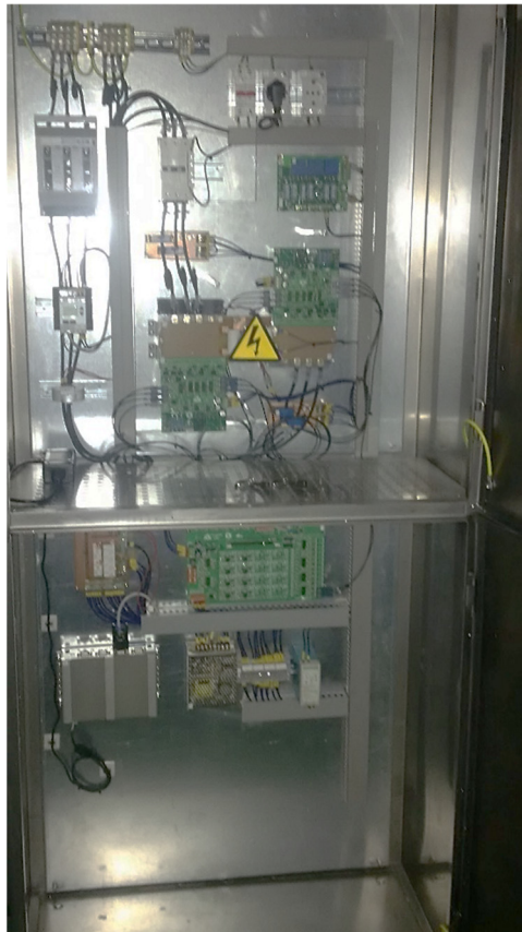
Imagen 15. Armario de control.
