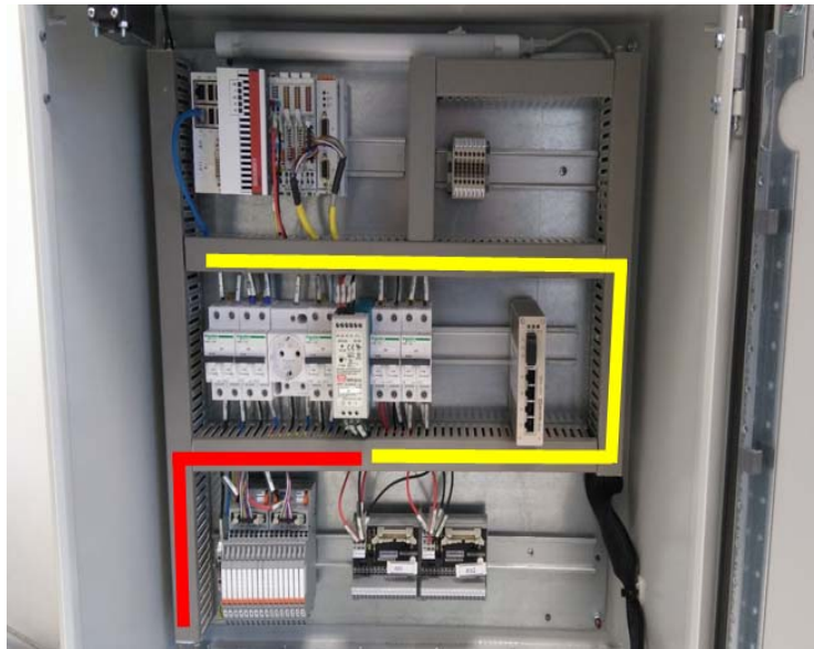
Figura 31: Distribución de cableado alimentación y datos ERU.
