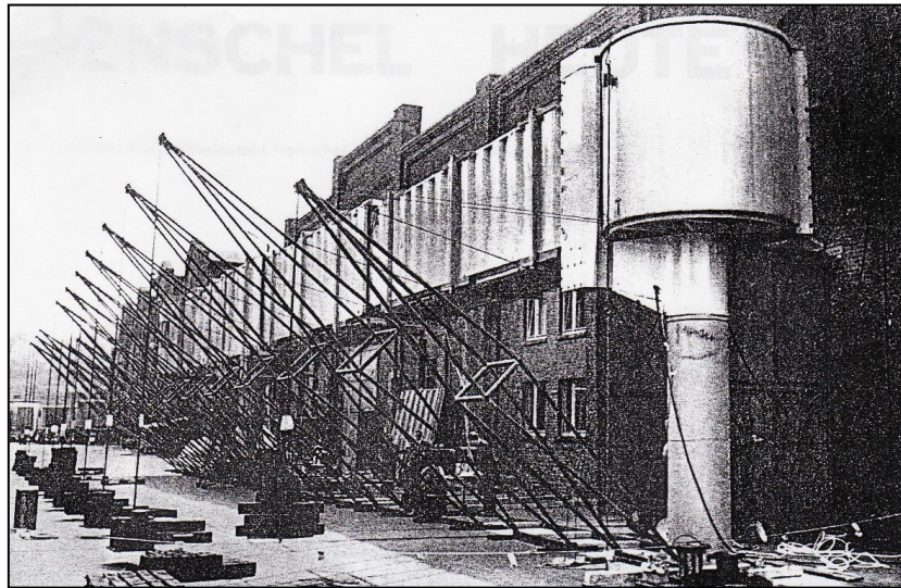
Imagen 3: Prueba de carga horizontal realizada en una pasarela Henschel en Rothendit mold (Kassel 1968).
