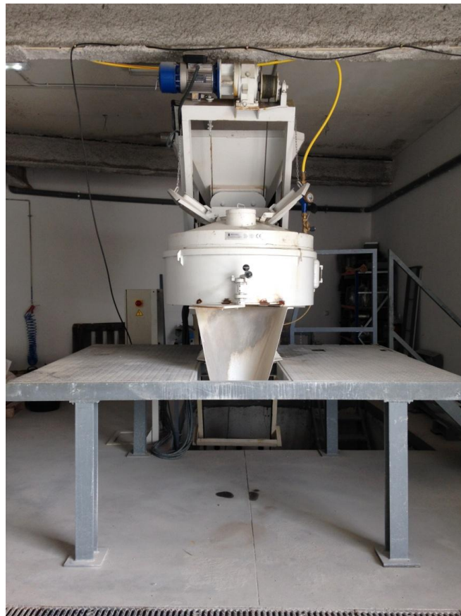
Fig. 6: Equipo de amasado de hormigones marca: Bentomass, modelo ST 150 CD
