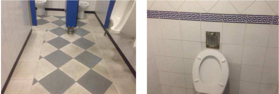
Figura 3.1 Estado actual Aseos antes de iniciar la reforma
