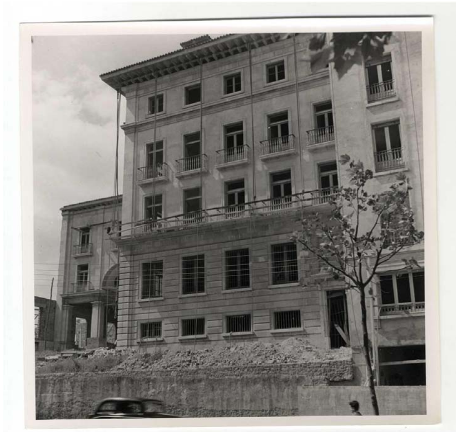
Fig. 57. Obras en el edificio de Jefatura de Obras Públicas en 1951. AGA, caja F-04227-016-005.
