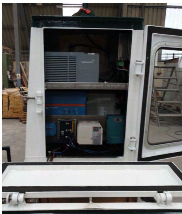
7.48.- Integración de los equipos eléctricos en la estructura del guardacalor.
