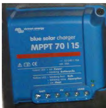
Figura 7.31.- Regulador de corriente DC/DC de las placas fotovoltaicas.
