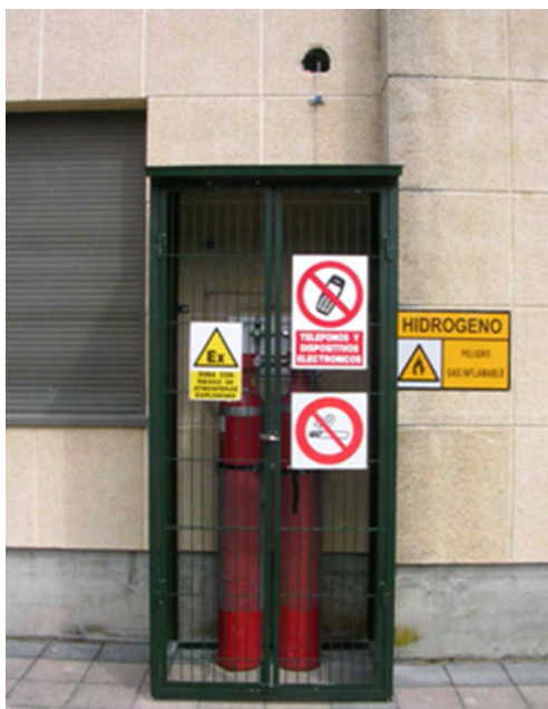
Figura 5.2.- Caseta para el almacenaje de las botellas de hidrógeno
