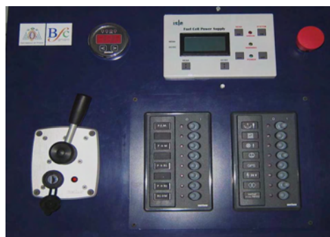
Figura 5.17.- Panel de operaciones.
