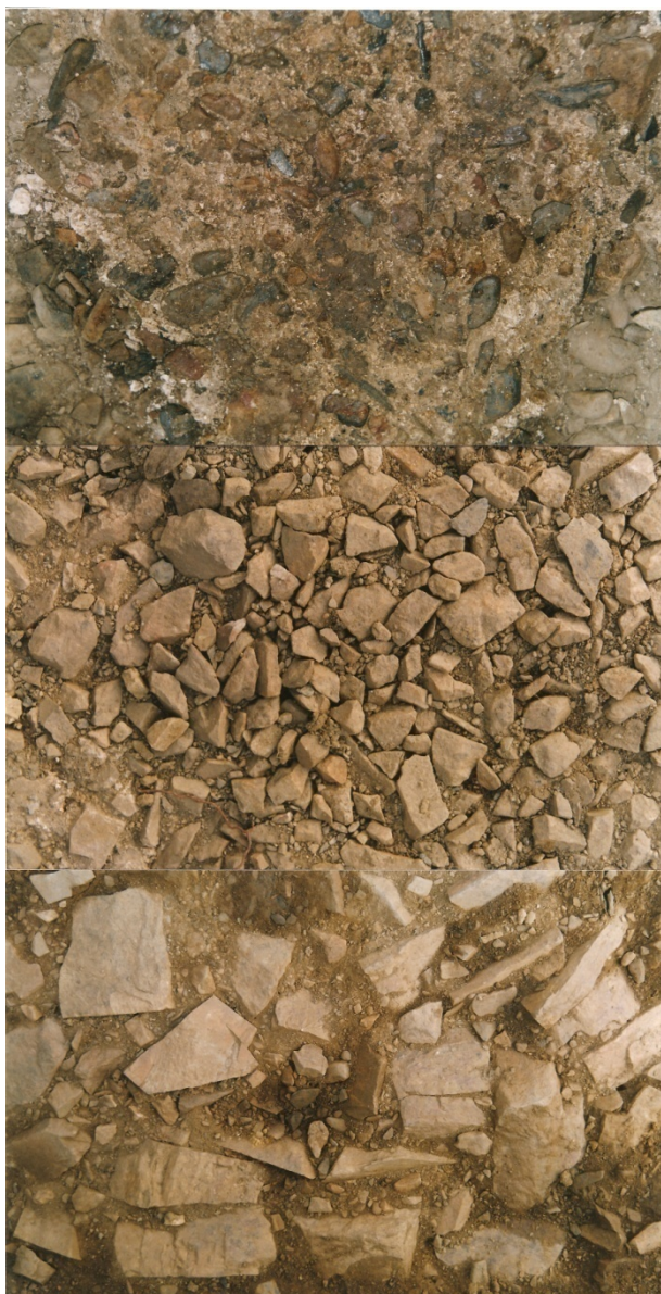
Capas superpuestas para la instalación de los pavimentos de las construcciones de nueva planta en el Chao Samartín (construcción C.2). Se trata de un remedo rústico de las recomendaciones vitrubianas para este tipo de obra (Villa, 2000).
