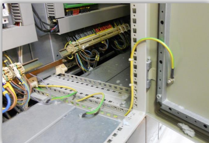
Figura 50: Conexión del conductor de protección a una puerta del armario eléctrico
