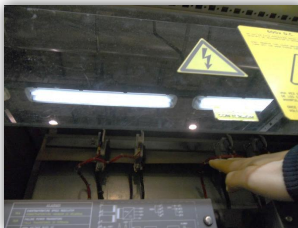
Figura 49: Acceso a partes peligrosas del armario eléctrico
