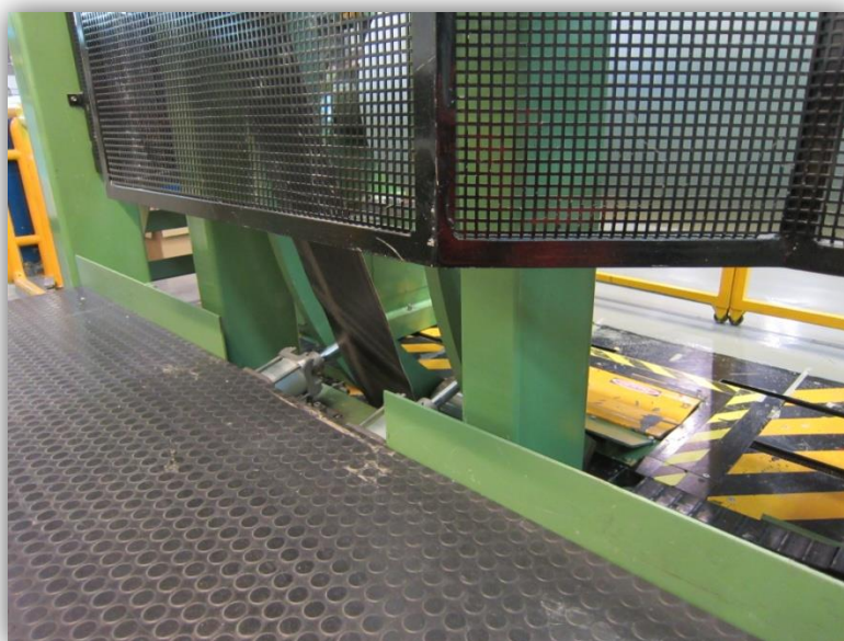
Figura 23: Zona con resguardo insuficiente
