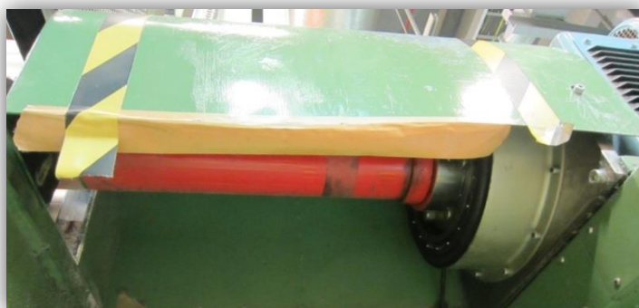
Figura 33: Resguardo insuficiente de los ejes de transmisión
