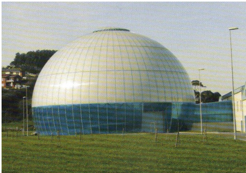
Fig. 163. Cúpula de la EDAR de Maqua.
