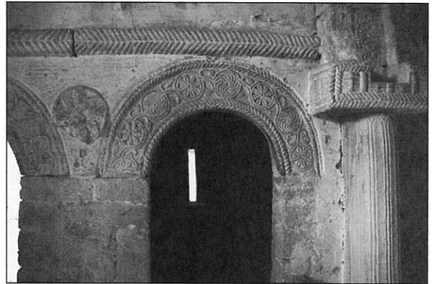
Fig. 6.- Detalle del arco monolítico de la habitación norte, con la columna del arco toral y el clípeo de la enjuta del arco
