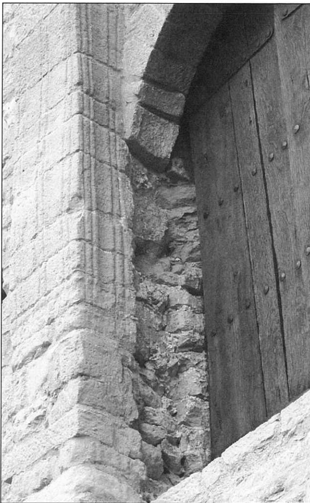
Fig. 25.- Huella de la jamba original de la ventana izquierda de la fachada norte. Se percibe el emplecton original
