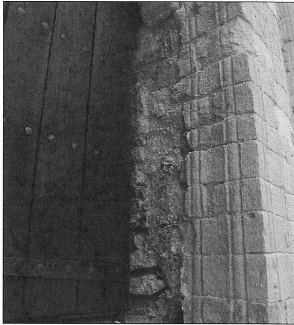
Fig. 29.- Huella de la jamba original de la ventana derecha de la fachada norte. Se percibe el emplecton original.
