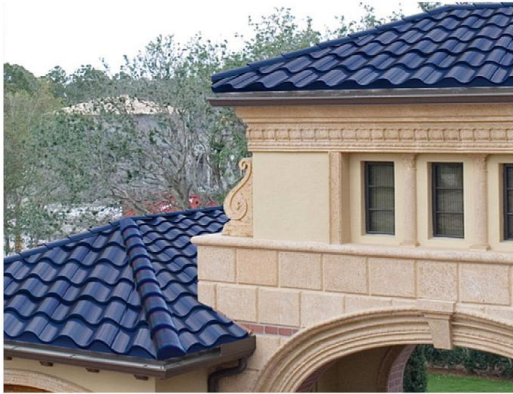
Figura 18. Uso de tejas fotovoltaicas en una cubierta.
