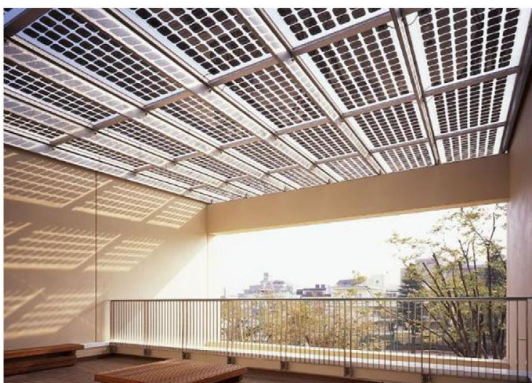
Figura 19. Lucernario con vidrios con mini-células fotovoltaicas.
