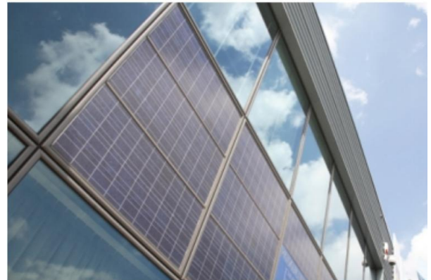
Figura 20. Paneles fotovoltaicos de cerramiento.
