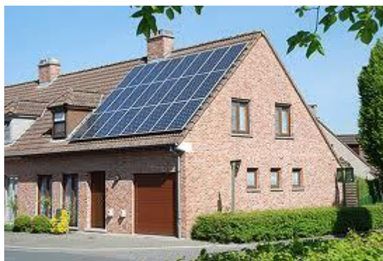
Figura 17. Mala integración arquitectónica de la energía fotovoltaica por la incorporación de módulos fotovoltaicos a la cubierta de una edificación.
