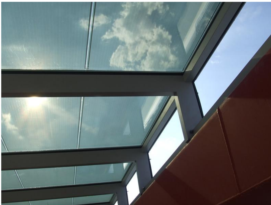
Figura 24. Ejemplo de aplicación de vidrios fotovoltaicos en un lucernario.
