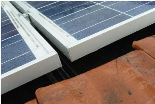
Figura 1. Incorporación de la energía fotovoltaica.
