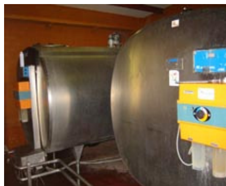
Figura 5. Tanques de refrigeración de leche cruda
