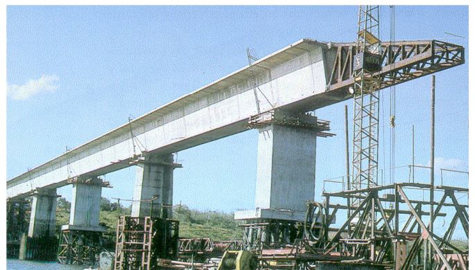
Figura 1 - Viaducto sobre el Río Caroní, Venezuela, primer puente "moderno" construido por empuje.
