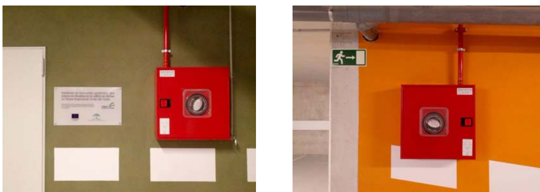
Imagen 4.1. BIEs instaladas en planta sótano. Elaboración propia.
