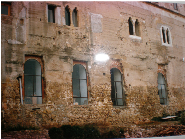
FIG. 223. SANTO DOMINGO EL REAL DE SEGOVIA. Fachada Norte del antiguo palacio románico durante las obras de restauración llevadas a cabo en 1974. (Foto del AMSDRS)
