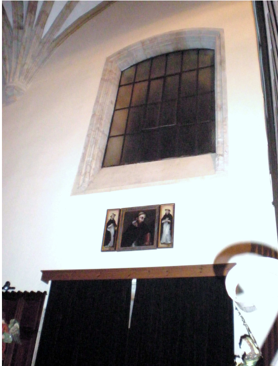
FIG. 13. VENTANA ABIERTA SOBRE LA PUERTA DE ACCESO AL CORO. (POSIBLEMENTE ANTIGUA PUERTA QUE DARÍA ACCESO AL CORO ALTO)
