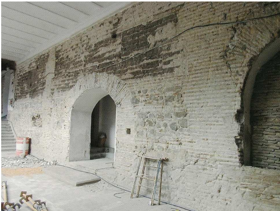
FIG.10. VISTA DEL MURO QUE SEPARA CORO E IGLESIA DURANTE LAS OBRAS DE REHABILITACIÓN.
