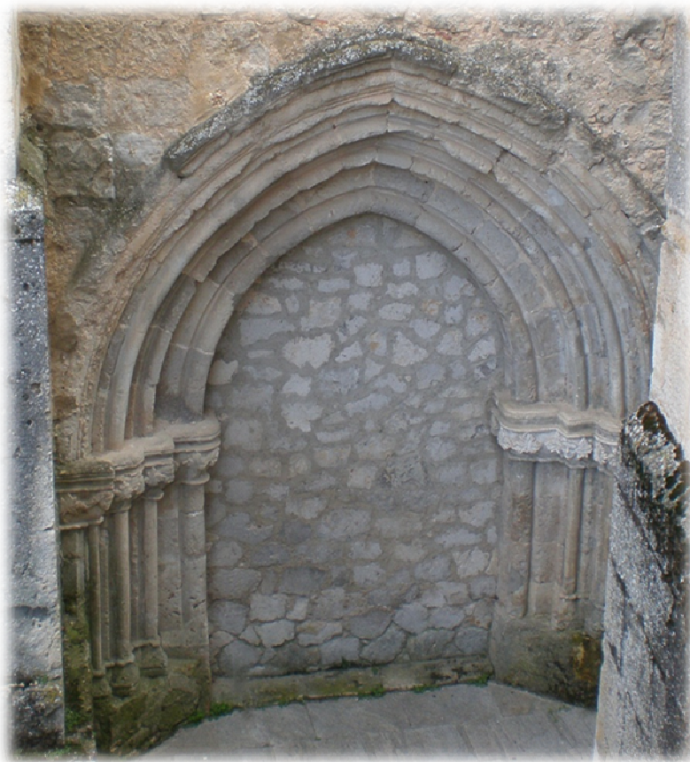
FIG.1. PRIMITIVA PORTADA DE ACCESO AL TEMPLO DE SANTA MARÍA DE CALERUEGA. LADO DEL EVANGELIO.
