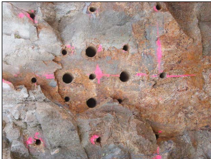
Ilustración 38: Cuele perforado de acuerdo al esquema de tiro. Aún se pueden ver las marcas de replanteo (fotografía del autor)
