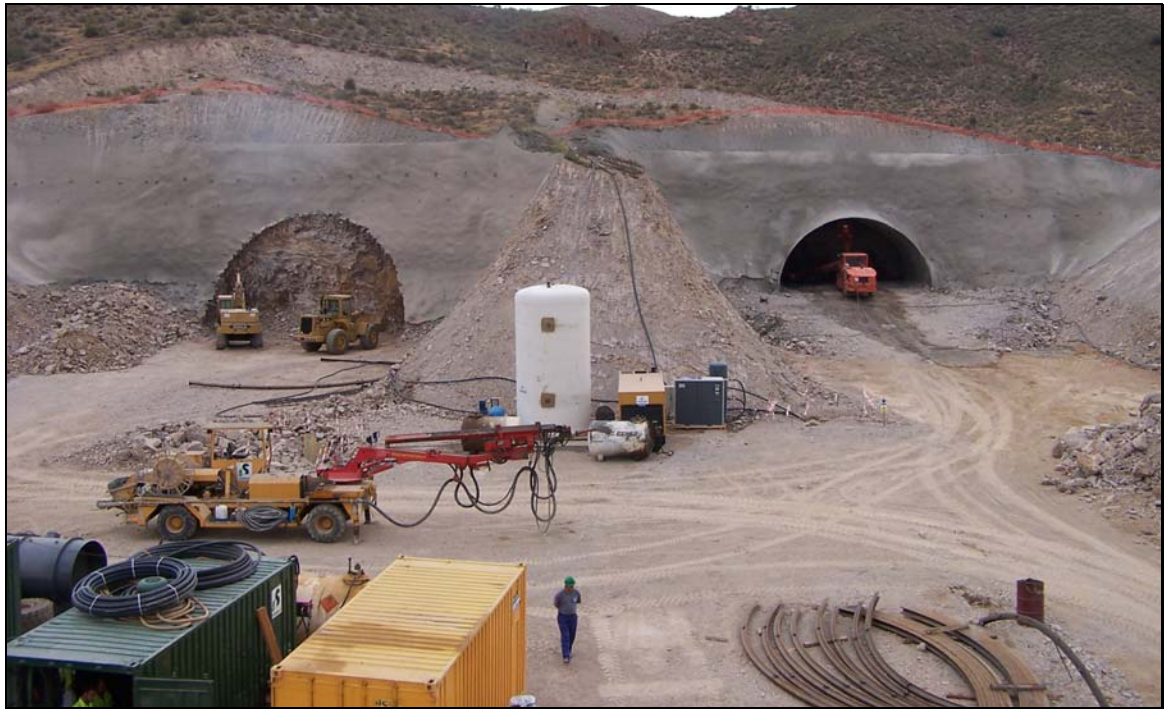
Ilustración 19: Túnel paralelo en excavación: “El Aguilón”, para Autovía A-7, tramo Cartagena-Vera (INSERSA) Dos métodos enfrentados: a la izquierda se ve un martillo realizando excavación mecánica y a la derecha el jumbo atacando la otra boca con perforación y voladura (Fotografía INSERSA 2006)
