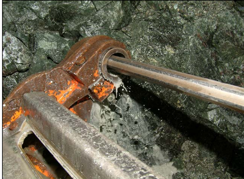
Ilustración 24: Detalle de la perforación con jumbo en skarn fresco en la mina de Boinás, en la preparación de cámaras a cota 225. La roca de tonos verdes que se aprecia en la fotografía es el skarn de extrema dureza, cuya perforación fue origen del problema que dio paso a la investigación que aborda esta tesis (Fotografía del autor)
