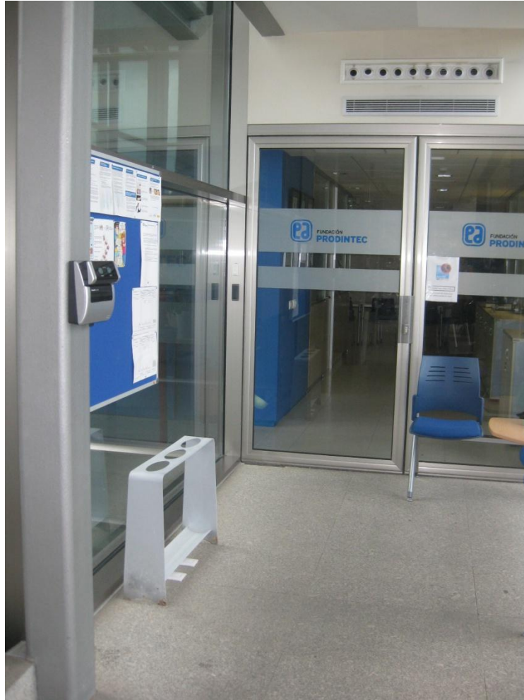
Ilustración 86.- Cámara de reconocimiento de iris en primer plano sobre la columna y antenas RFID ocultas en falso techo.
