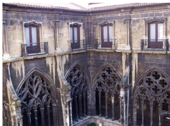
Figura 1. Ángulo sudeste del claustro de la catedral de Oviedo, antes de la intervención.
