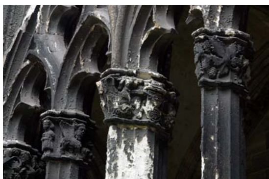
Figura 5. Tracerías de los ventanales y capiteles antes de la intervención. Puede observarse el grado de ennegrecimiento y algunas zonas disgregadas, especialmente una columna.
