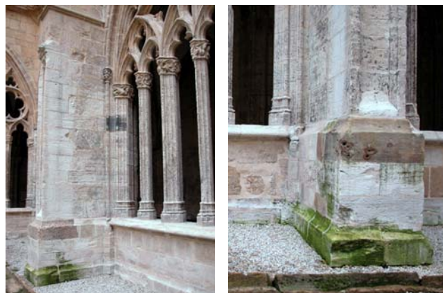
Figura 10. Desarrollo de algas verdes en los sillares inferiores de un contrafuerte.
