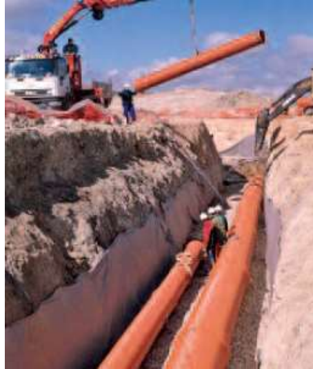
Ilustración 6.6 Tuberías de PE-100
