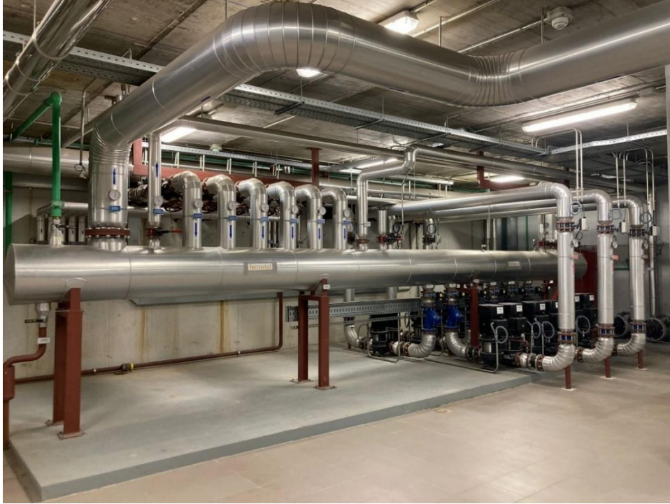
Figura 4.7.- Sistema de bombeo.
