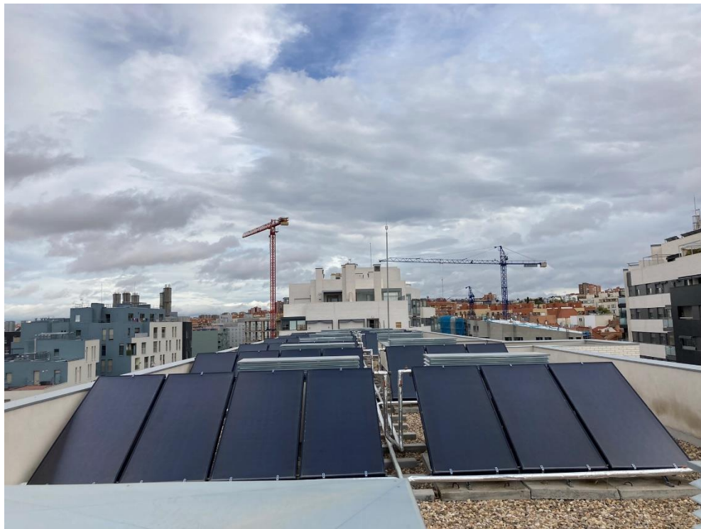
Figura 5.2 Colectores solares situados en la azotea del edificio.
