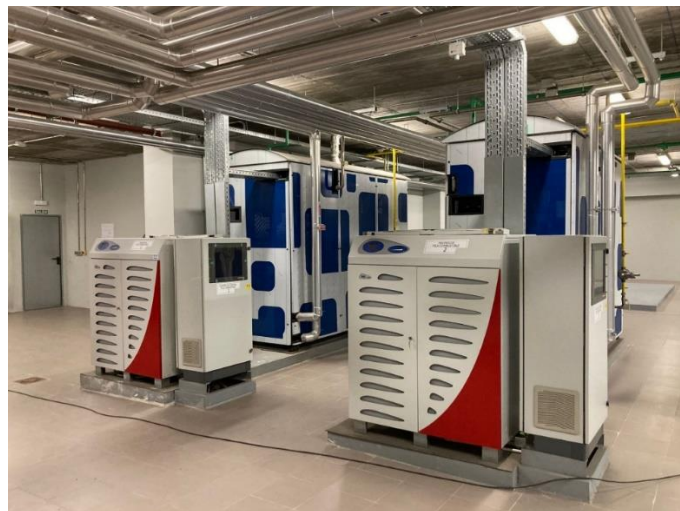
Figura 4.11.- Pilas de hidrógeno instaladas en la Central Térmica
