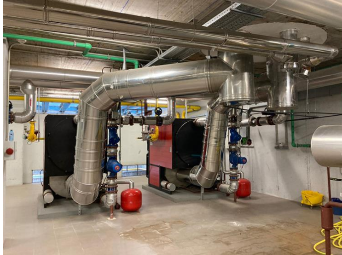
Figura 4.6.- Imagen de las calderas ICI Caldaie.
