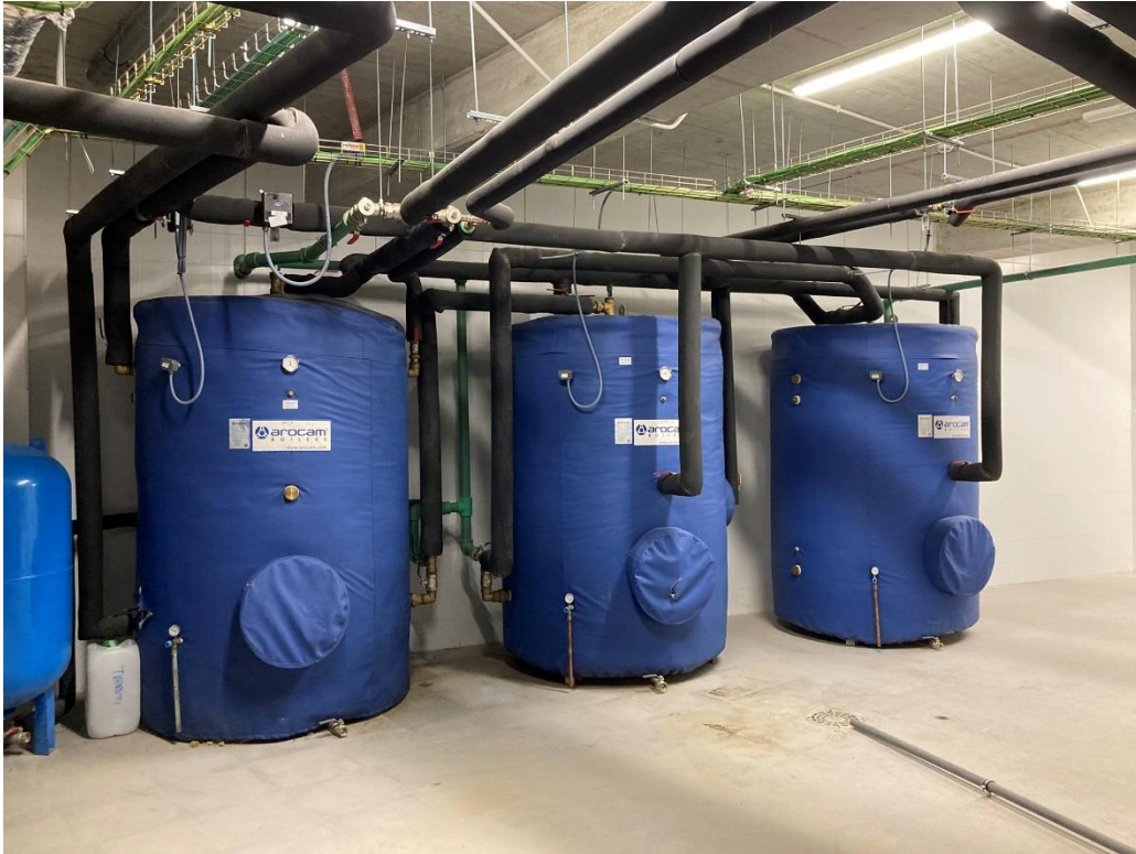
Figura 4.10 Depósito de acumulación de ACS (izquierda) e interacumuladores solares.
