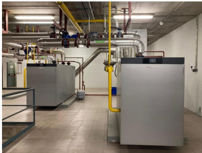
Figura 4.5.- Imagen de las calderas Viessman.
