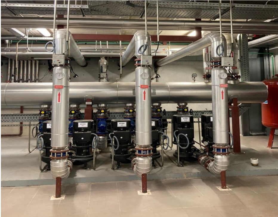
Figura 4.8.- Ubicación de las diferentes bombas
