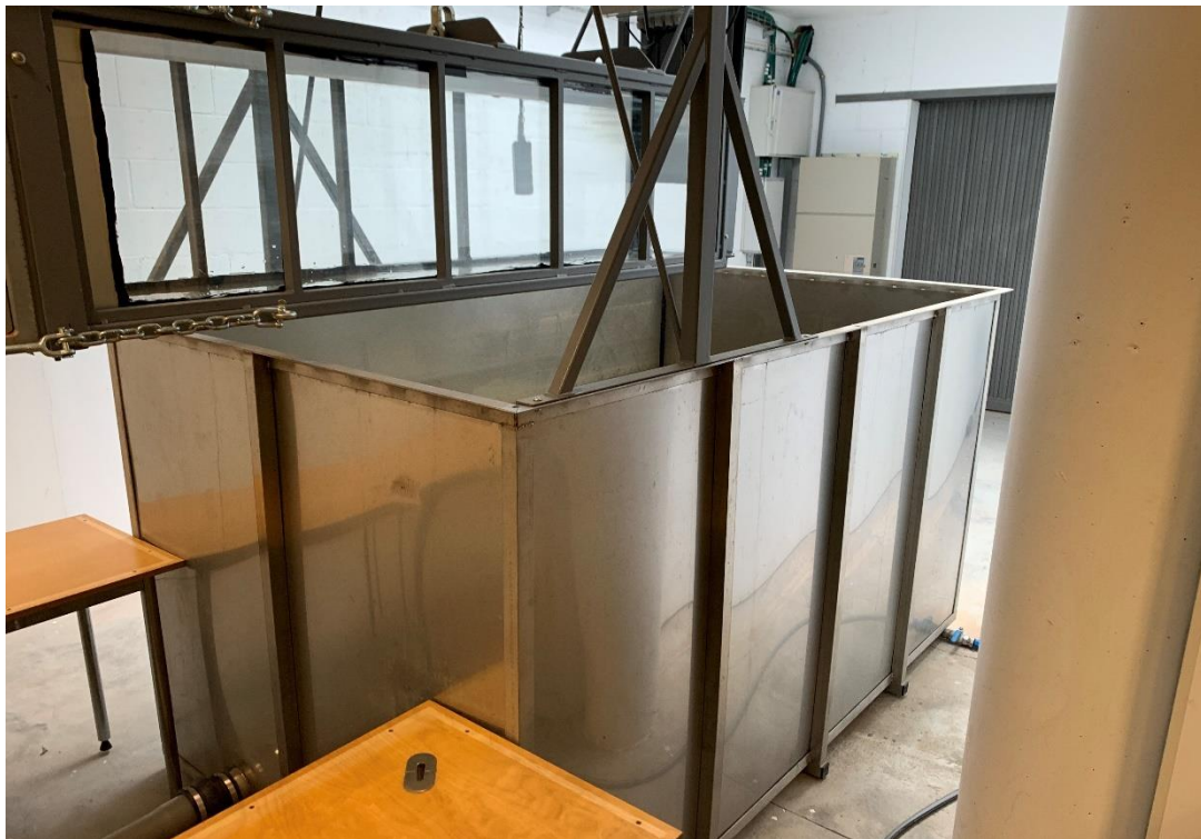
ILUSTRACIÓN 41. TANQUE DE ASPIRACIÓN
