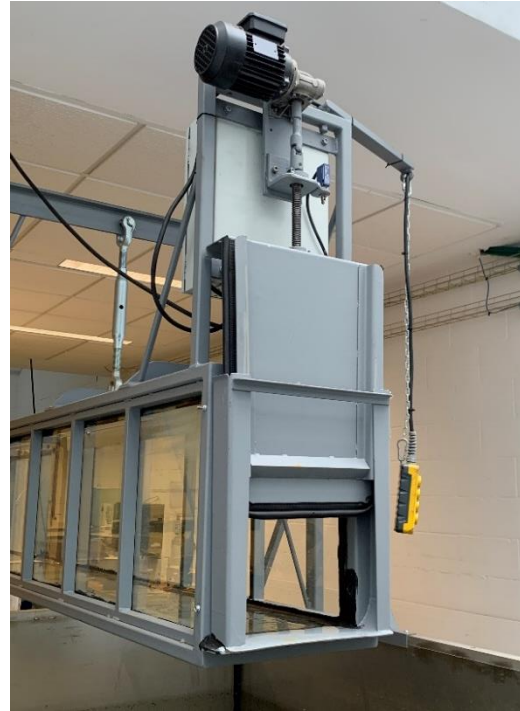
ILUSTRACIÓN 46. COMPUERTA DE CONTROL
