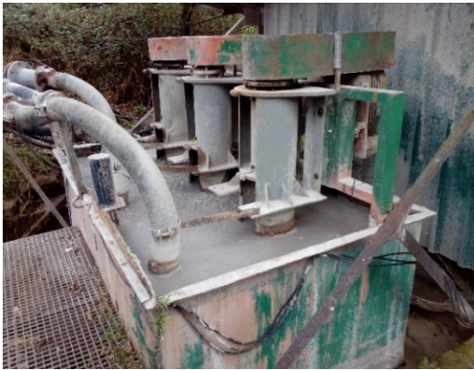
Instalación de bombeo y clasificación.
