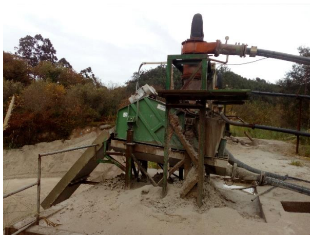
Figura 42. Instalación de escurrido de residuos.
