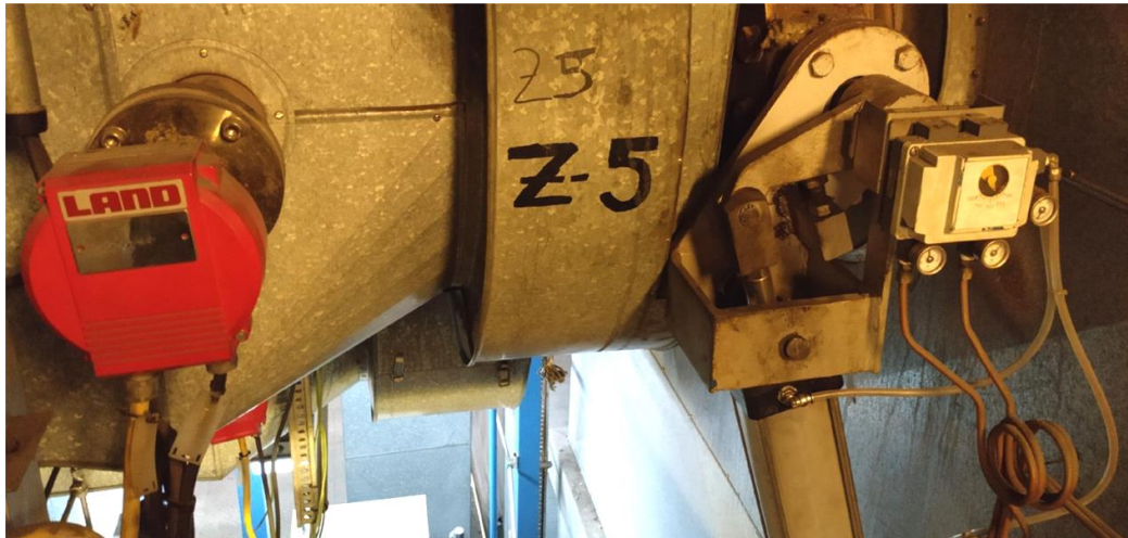
Figura 3.8. Válvula de humos de la Zona 5, a la izquierda se observa el sensor de oxígeno.
