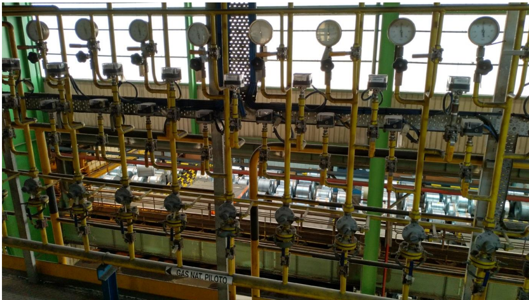
Figura 3.7. Sistema de válvulas de gas de los pilotos de una zona.
