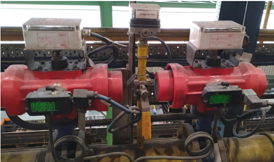
Figura 3.6. Válvulas de seguridad de gas.
