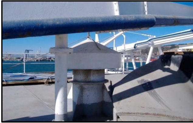
Figura 49. Salida aire filtrado.
