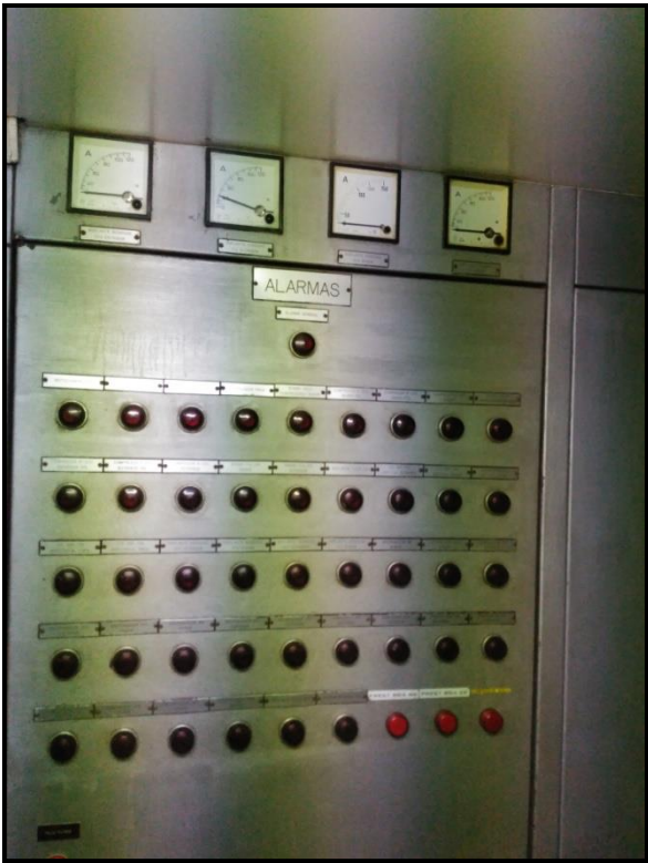
Figura 70. Panel de alarmas.
