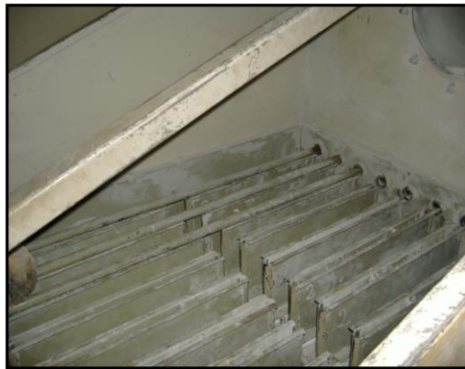
Figura 47. Tubos de inyección de aire montados sobre las rejillas.
