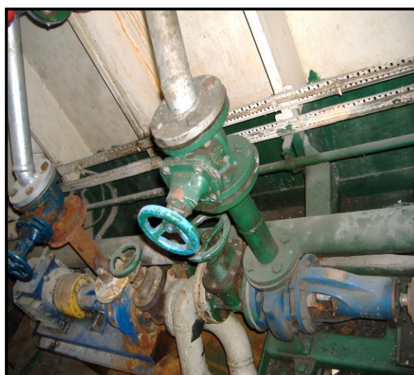
Figura 66. Bomba de refrigeración mediante agua salada.
