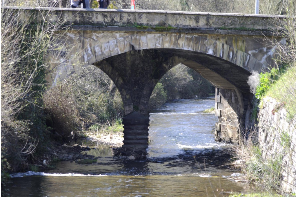
Fig. 162. Estado actual del puente de Cabojal aguas arriba. Fotografía Sara González García
