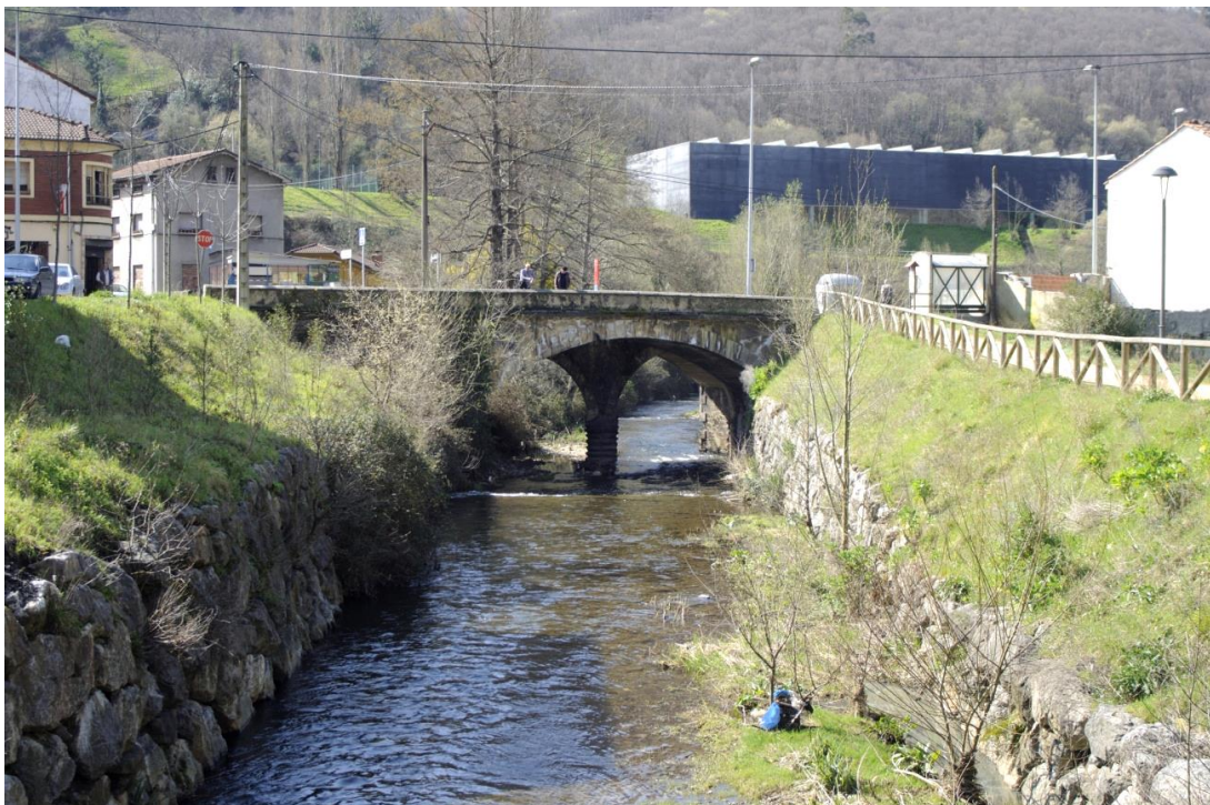
Fig.264. Estado actual del puente de Cabojal sobre el río Turón. Fotografía Sara González García
