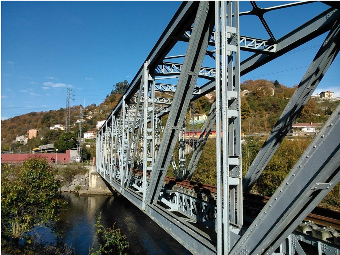
Fig.114. Puente sobre el río Nalón, de la línea férrea de Sama a Samuño, Ferrocarril de Langreo. Hierro laminado. Empresa constructora: Fábrica de Mieres. A la derecha, en primer término, detalle del roblonado. 1896. Fotografía de la autora
