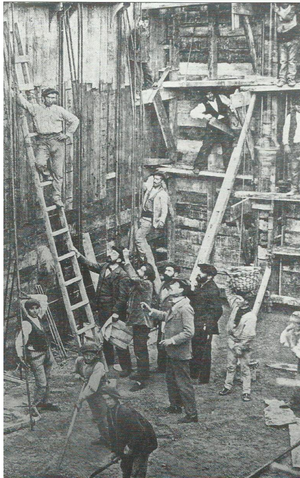
Fig.181. Obras en del depósito de Llanes. Revista El Cemento Armado No.9 año 1901
