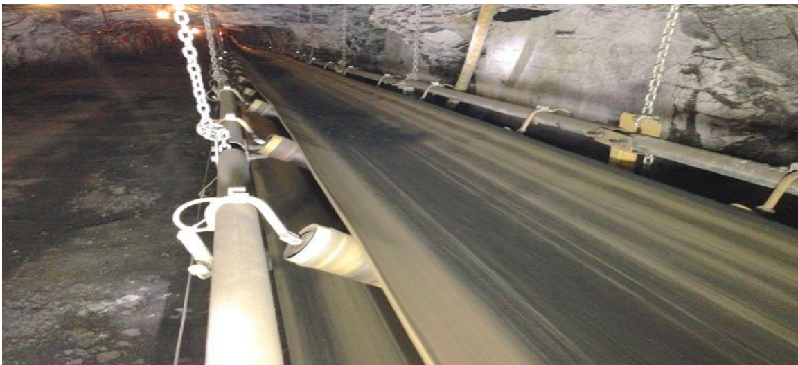
Figura 15. Ejemplo de una cinta transportadora en un túnel.
