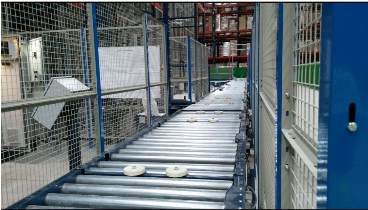
Figura 6.16. Aspecto de la instalación durante la puesta en marcha.
