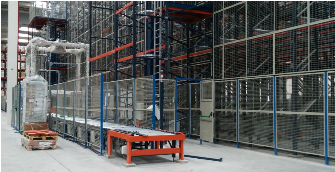
Figura 6.17. Aspecto de la instalación durante la puesta en marcha.
