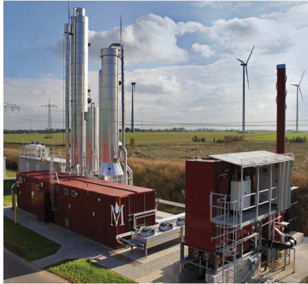
Figura I.4 Planta de absorción física con agua para purificación de biogás en Nauen (Alemania). Capacidad: 1250 \text{ Nm}^3 \text{ h}^{-1} . Imagen de Malmberg Water [28].
