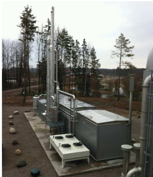
Figura 1.6 Instalación de absorción química para purificación de biogás en Suecia. Imagen de Purac Puregas [27].
