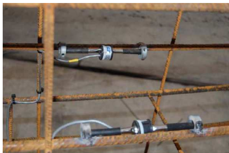
Figuranº6: Pareja de extensómetros de cuerda vibrante instalados en la armadura de la dovela.
