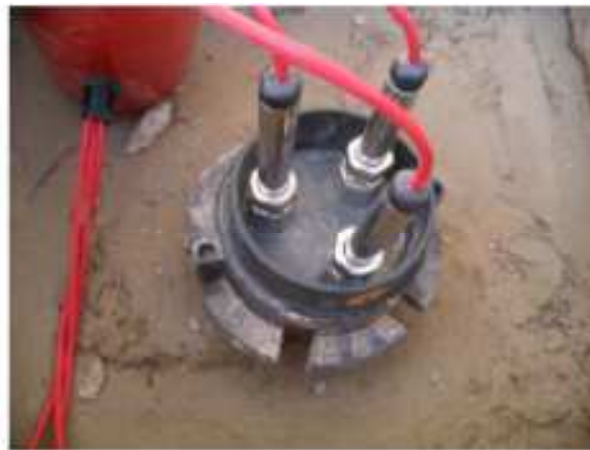
Figura nº1: Cabezal de un extensómetro de 3 varillas
