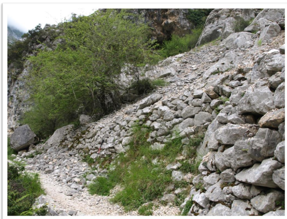
Figura 49. Escolleras en estado precario en uno de los tramos de la Ruta del Cares
