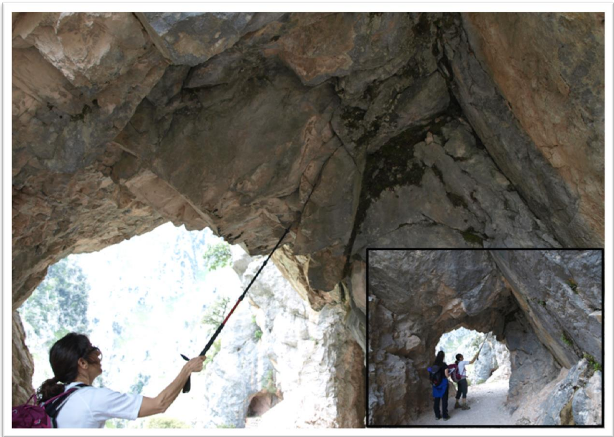
Figura 43. Grietas en uno de los túneles de la Ruta del Cares
