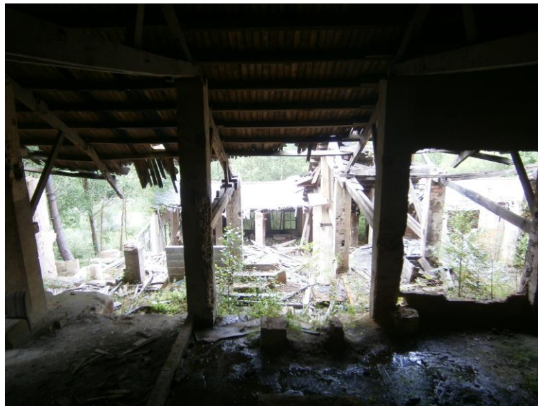
Figura 1. Restos de la construcción del lavadero de la mina de W de Boal
