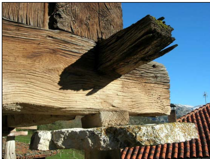
Fig. 141 c. Detalle de los anchos traveses ensamblados a media madera. El pegollo dispone de amplias muelas, con taco entre la muela y el trabe.
