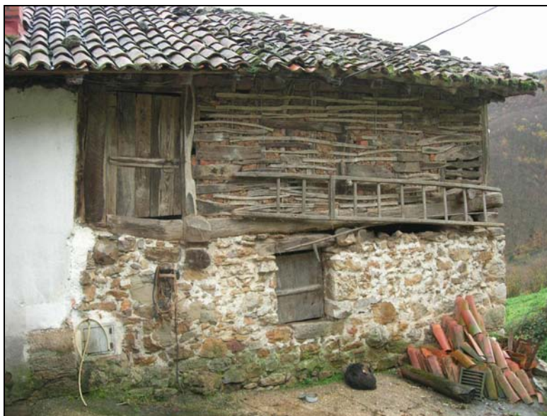
Fig. 107 a. Cuadra y tenada de la casa de los Tuñón. Se cita en 1766, aunque la familia consta asentada allí desde antes de 1533. El edificio actual responde a dos fases: la mitad inferior supone una primera fase en mampostería con su propia entrada o “boqueirón” de la tenada en este frente occidental. La segunda fase se construye en entramado de varas de madera rejunteado con arcilla, piedras y tejas y una entrada más amplia.
