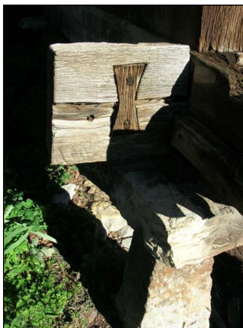
Fig. 151 b. Detalle de las grapas de madera en cola de milano empleadas en los traves.
