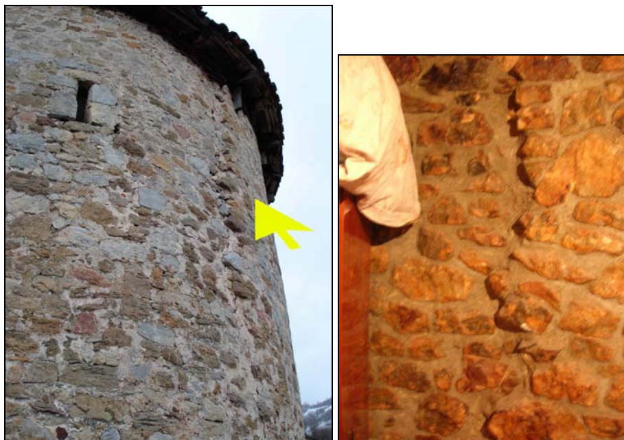
Fig. 44 c y d. En este caso puede observarse la gran grieta que recorre el muro desde la base hasta la techumbre y un detalle suyo en el interior del 2º piso
