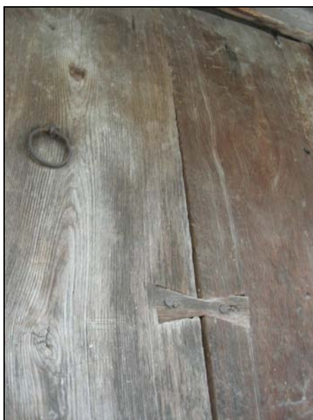
Fig. 150 b. Uso de grapas de madera en cola de milano, propio de la reforma del XVIII.
