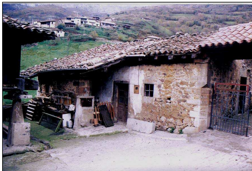
Fig. 52. Edificio que domina el acceso a la antojana del palacio y que quizá sustituyó a la caballeriza citada en 1752 como parte del edificio palatino. Está dotado de un subterráneo que la tradición identifica como antigua cárcel del pueblo. El edificio original sólo comprendía la mitad oriental, con entrada desde la calle. Destaca la esquina moldurada en rebaje a listel en el que se encaja la puerta de acceso al recinto cercado de la quintana.
