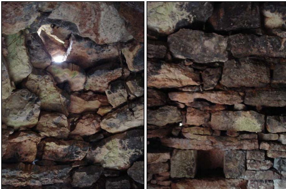
Fig. 128 a y b. Sistema en falda cúpula mediante aproximación de ringleras planas que se disponen de forma concéntrica al eje central de la cubierta. Lateral oeste, con la pequeña hornacina y el arranque de la falsa cúpula marcada por las piedras más voluminosas.
