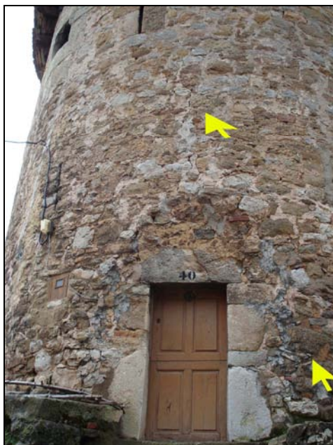
Fig. 41. Puede apreciarse el gran orificio de contorno irregular que fue practicado para introducir una nueva puerta, luego relleno con una fábrica de mampuestos más rudimentaria y la grieta ocasionada por los problemas estructurales.
