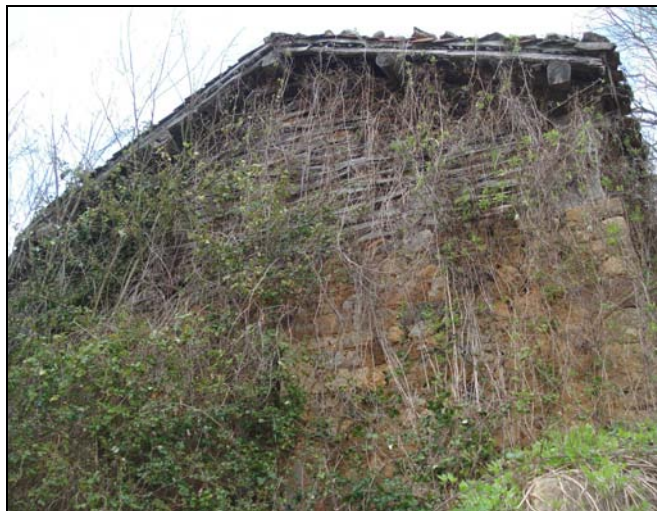
Fig. 113 a y b. Casa nº 3, con su proceso de degradación entre 2006 y 2011
