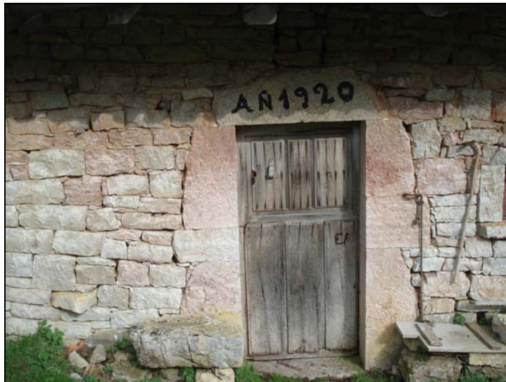
Fig. 137. Detalle de la fábrica de mampostería y sillarejo bien concertada y careada y del trabajo de cantería a cincel que acompaña a los vanos de la construcción.
