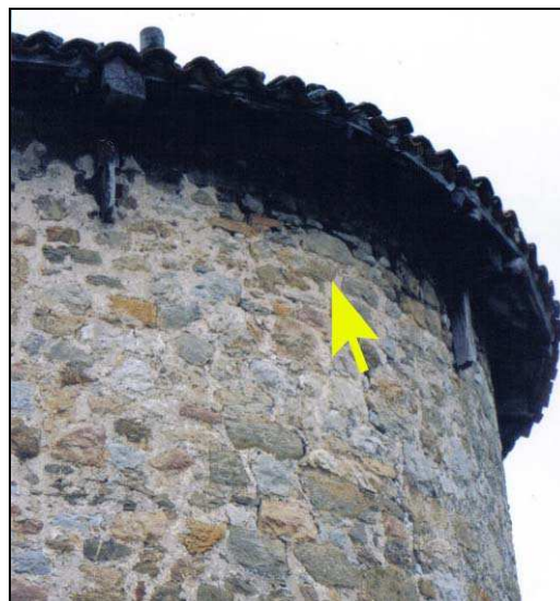
Fig. 44 b. Detalle de la refacción obrada en la base de la cubierta. Se aprecian las grapas de madera que encastran el faldón en el muro.
