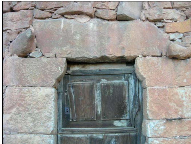
Fig. 117 b. Detalle de las impostas con remate circular que sostienen la jamba, similares a las existentes en las ventanas cortejadoras de la torre circular y otras arquitecturas de la aldea.
