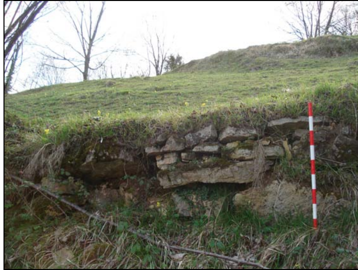
Fig. 179 c. En algunas zonas, los bancales son mixtos y emplean parapetos complementados con los propios afloramientos calizos, aunque su fábrica es extremadamente rudimentaria y sin duda mucho más tosca que los parapetos de los grandes cortinales.
