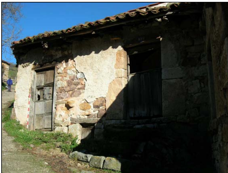
Fig. 78. Fachada principal, con las dos entradas al pajar y el portal de la casa, y el pequeño ventanuco de la cuadra al nivel de calle.
