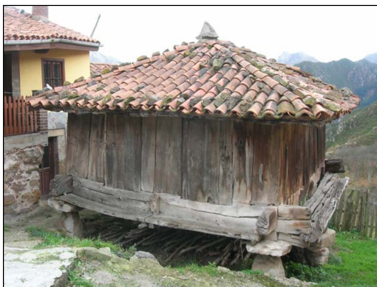
Fig. 146 a. Hórreo que en 1752 se repartían los miembros de la familia Fernández, vecinos del pequeño barrio del Tarano. El primer hórreo, datado en el XVI, actuaba de eje de la barriada al ubicarse en la quintana central y señala una fecha relativa para el proceso colonizador de esta zona, protagonizado por una familia campesina. Posteriormente, vivió reformas en el XIX.
