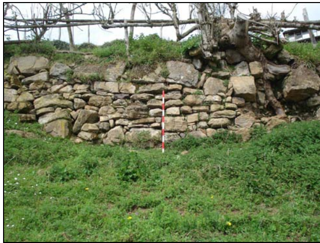
Fig. 125. Parapeto correspondiente a la tercera terraza. Pese a que la composición es de inferior calidad, aún da muestras de un trabajo cuidado en la selección y colocación de los mampuestos.
