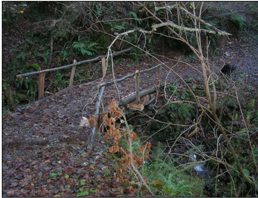
Fig. 64 a. Pontón del Paladón. Con el mismo tipo de fábrica mixta, su mayor altura y el mayor riesgo para el tránsito llevaron a la colocación de una barandilla de madera. Las estructuras lígneas fueron repuestas hacia el año 2005, demostrando la perduración de estos mantenimientos atávicos.
