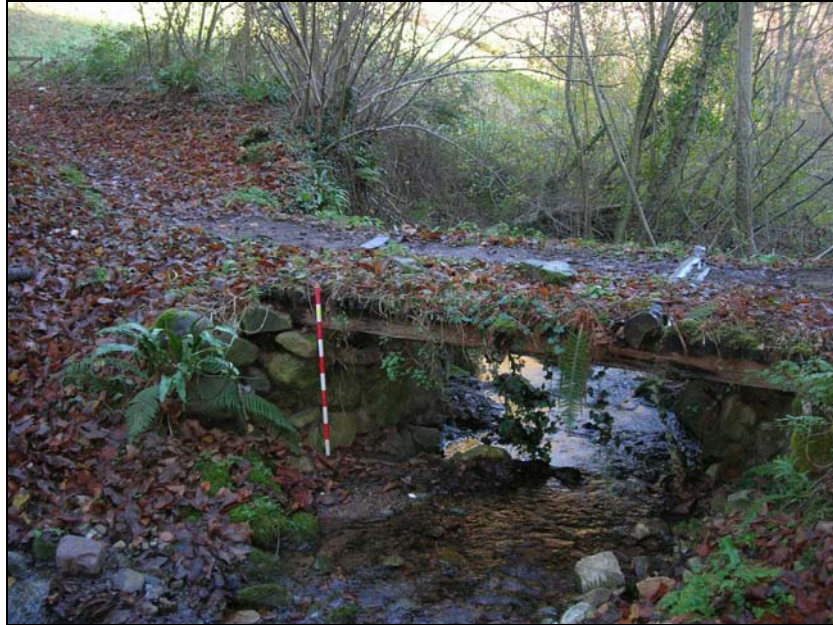
Fig. 63 b. Pontón de la Toba. Detalle de su fábrica mixta de mampostería a hueso y madera
