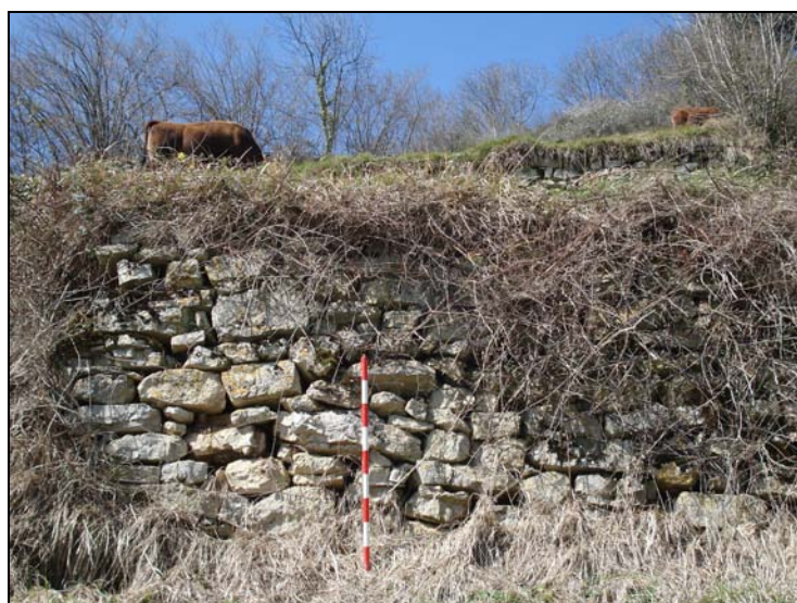
Fig. 174 a. Primera modalidad empleada en el sistema de terrazas. Banal con parapeto de mampuestos calizos ligeramente desbastados y dispuestos a hueso.
