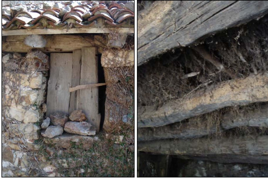
Fig. 132 y 133. Además de la puerta que daba acceso a la cuadra, la tenada superior contaba con un pequeño boqueirón en el lateral W, cerrado con contraventana. Internamente, se organiza en dos alturas destinadas a cuadra (piso bajo) y tenada (hueco de la cubierta a dos aguas). Las separa el solláu de la tenada superior, construido a base de “xebatu” o entrelazado de varas de avellano.
