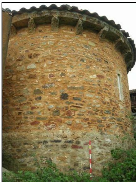
Fig. 5. El ábside románico de la iglesia se levanta sobre una gran banqueta en resalte que permite salvar el desnivel de la pendiente y compensar la presión de la cubierta maciza. La testa de la banqueta está marcada por una hilada de sillares de toba.
