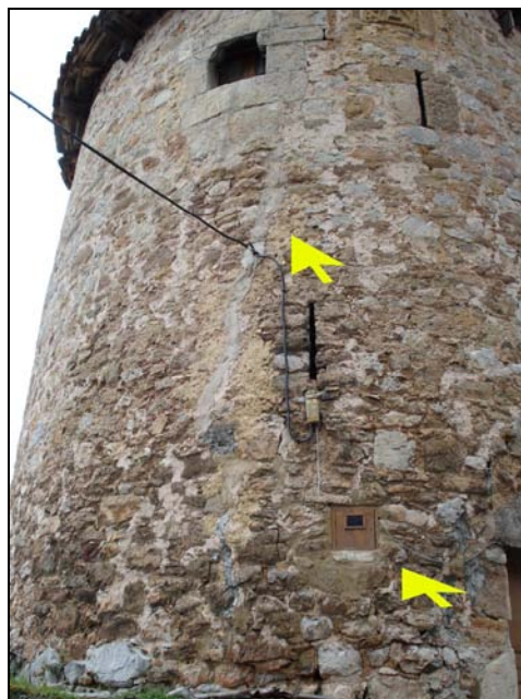
Fig. 31. Las ventanas cortejadoras provocaron daños estructurales al edificio. Puede apreciarse la amplia grieta que desciende desde el antepecho de la ventana, señalada por la flecha superior.
