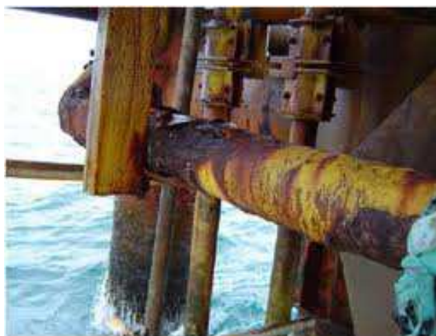
Fig. 6 Corrosión estructura offshore
