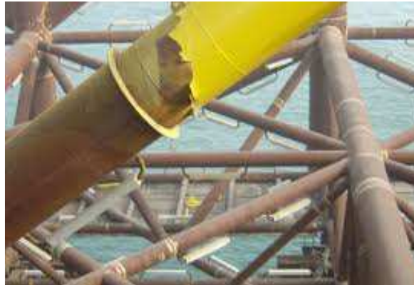
Fig. 16 Pérdida de recubrimiento protector en una estructura offshore
