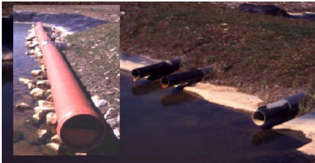
Figura 32. Detalle de las tuberías de desagüe al S.A.P.S. 3
