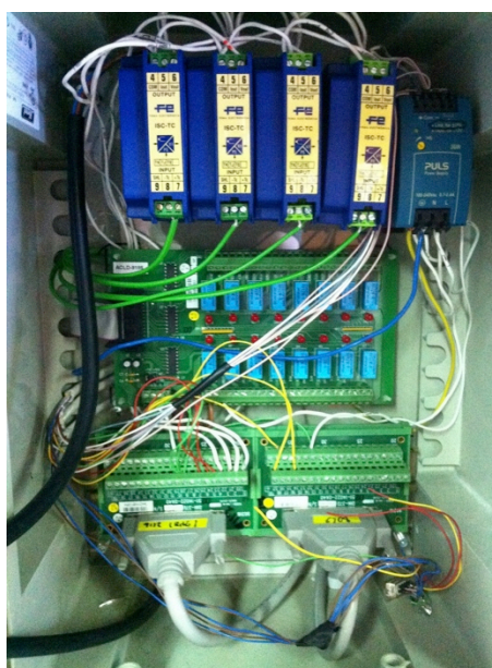
Figura 42. Fotografía del autómatas construido para la unidad de flujo inverso isoterma.
