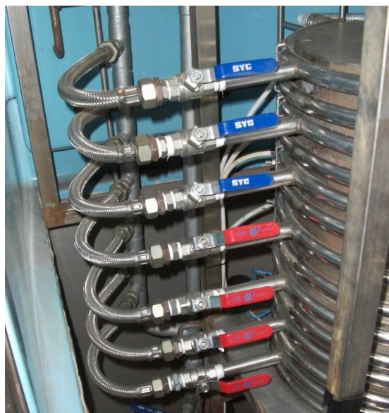
Figura 44. Vista de los conductos de alimentación de aire ambiental a cada una de las secciones.
